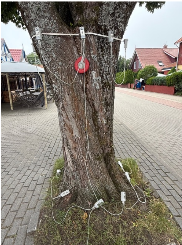
Šiaurinėje kamieno pusėje jungtyje tarp šakų yra įtrūkimas
