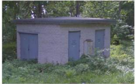
4 pav. ESO elektros transformatorinė TRN-33.
