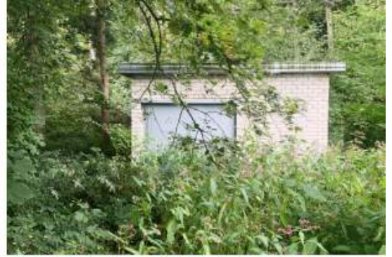
3 pav. ESO elektros transformatorinė TRN-33.
